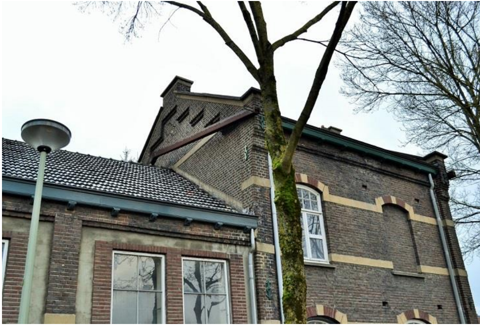
Foto onderzoeksteam, detail trekstangen rondom bovenzijde mijnpolitiewoning, 21 februari 2015
